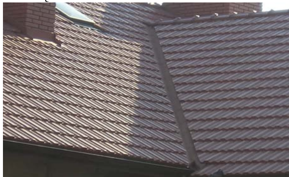
Rys. 14. Obróbka blacharska kosza. [zdj. aut.]
